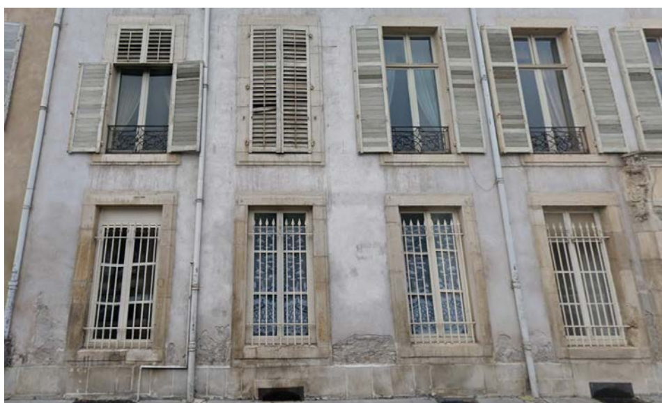
Vue de la partie basse d'une élévation donnant sur la place de la Carrière : enduit ternis et lacunaire, contrevents abîmés... © Google
