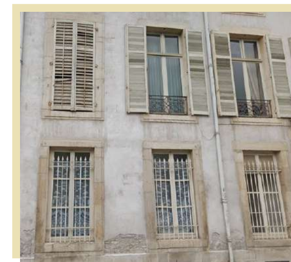
Vue de la partie basse d'une élévation donnant sur la place de la Carrière : enduit ternis et lacunaire, contrevents abîmés...
