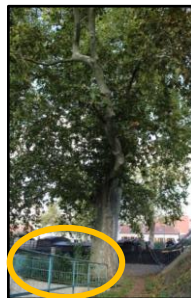
Garde-corps à repeindre.
